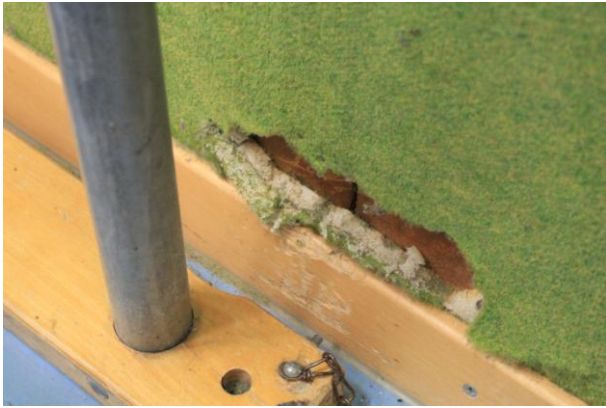
Defekter textiler Prallwandbelag
