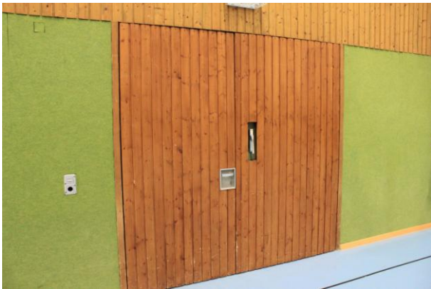
Hallenaußentüre schließt nicht richtig
